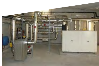
Le local pompe à chaleur
