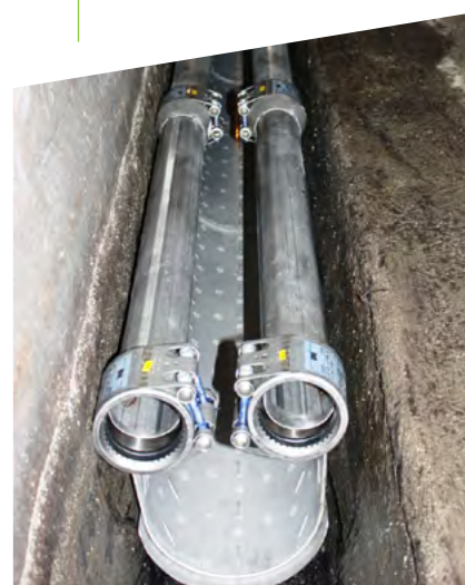
92 m² d'échangeurs sont placés dans les 176 m de canalisations d'eaux usées
