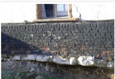
Déchaussement d’un mur
