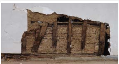
Pourrissement des bois
