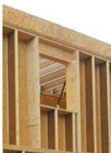
Caissons d'insufflation en bois. ©AQC-2015
